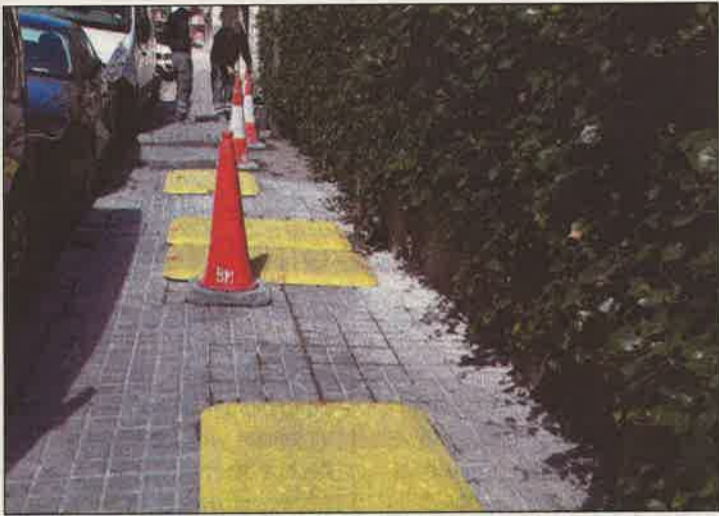
FOTO: El Clot / La Paeria ha cubierto los tramos dañados
